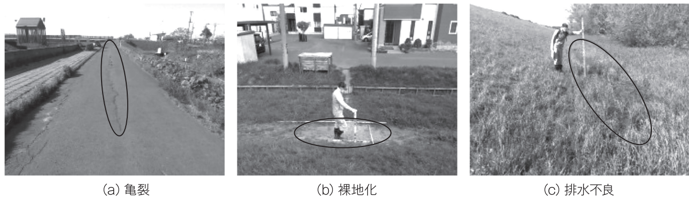
図3: 現地で見られた堤防の変状
