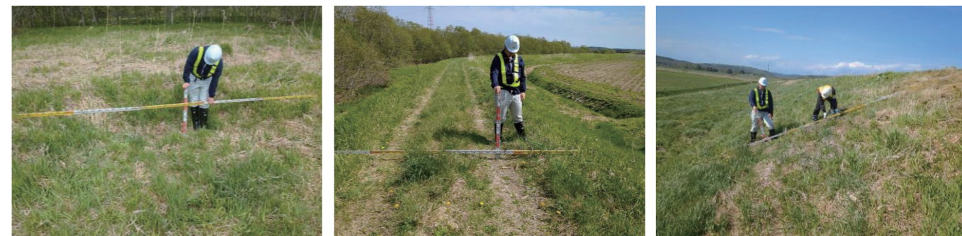
図3：堤防点検によって確認された変状 (左：法面のはらみだし、中：天端の不陸、右：高水敷と法面の陥没)
