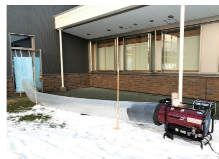
図2：ダクトヒータとビニールダクト
